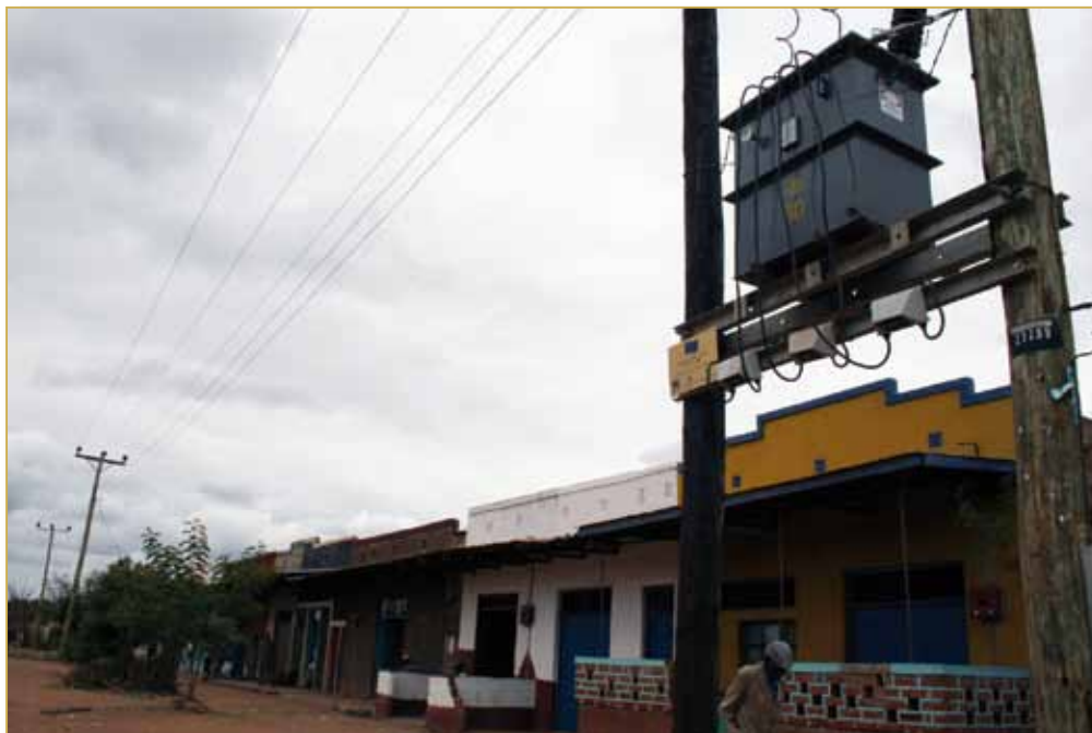
Alimentation en électricité au Kenya. © Union européenne
