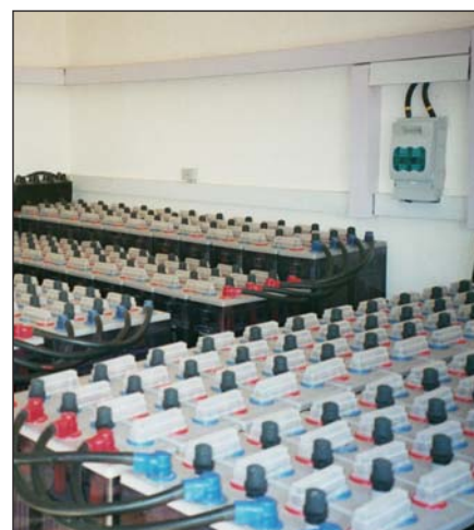
Centrale batteries de Kimparana (Mali).
