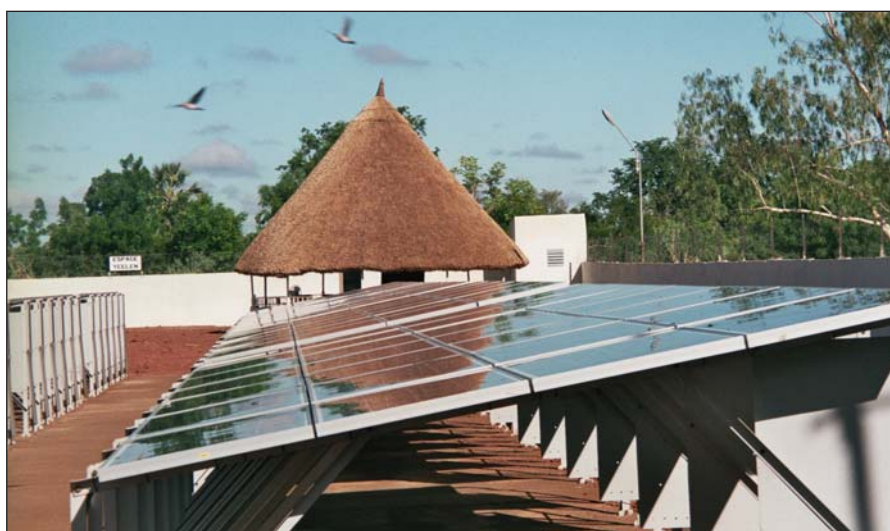
Centrale photovoltaïque de Kimparana (Mali).
