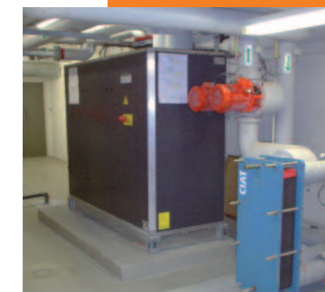
La pompe à chaleur
