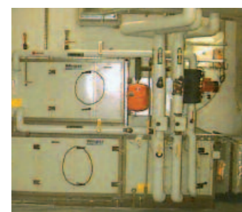
Les pompes à chaleur
