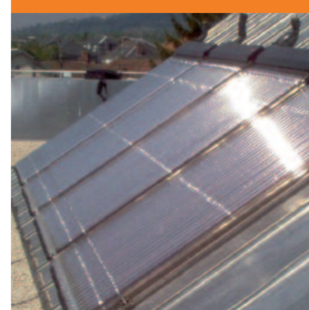
4 panneaux solaires d'une surface de 8 m² pour la fourniture de 60% de l'Eau Chaude Sanitaire
